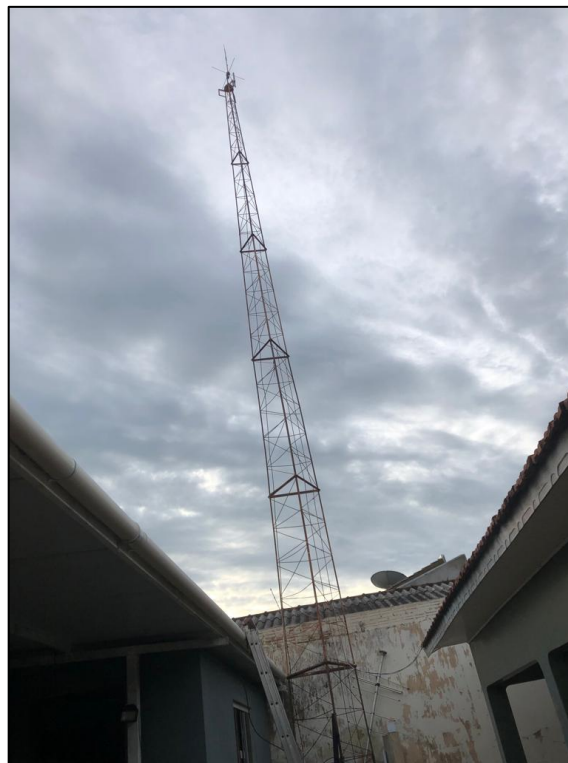
Figura 33: Infraestrutura da torre para montagem da estação de controle. Fonte: Do autor.
